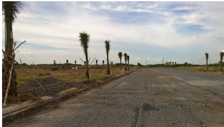
KDC Long Thới – Nhơn Đức của ITC đang được san lấp và hoàn thiện hạ tầng
