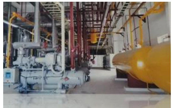
Hình 11: Hệ thống lạnh
